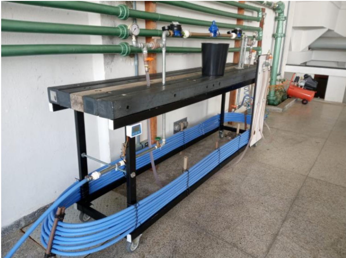
Figura 3 - Vista lateral esquerda da bancada de testes onde se verifica os hidrômetros e a ventosa eliminadora de ar instalados no cavalete de teste.
